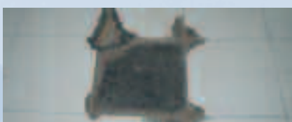
Dalles vinyle amiante dégradées
